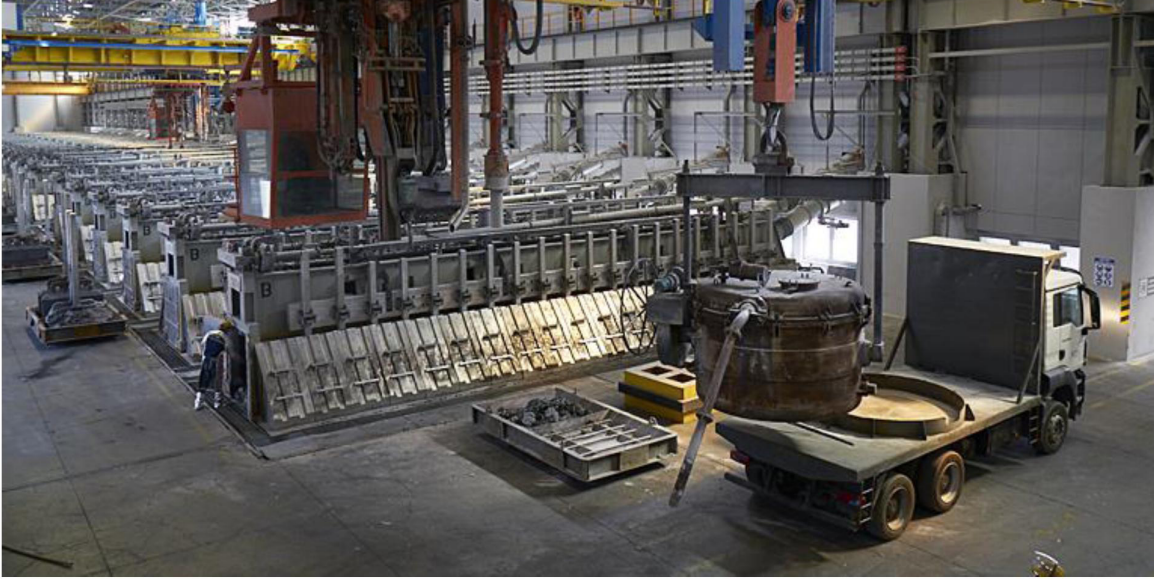
Şekil 20: Birincil Alüminyum Üretim Tesisi Elektrolizhane
