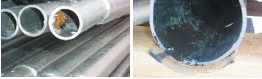
Resim 12 - Borularda kaplanmamış bölgeler
